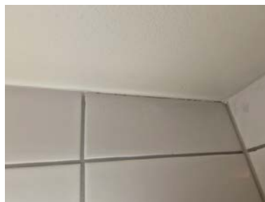
Sprekker i fuger mot tak.
