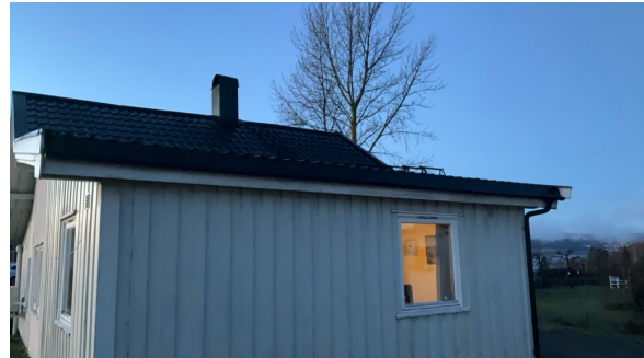
Takrenne er bøyd/deformert etter snøras eller ising i renne.
