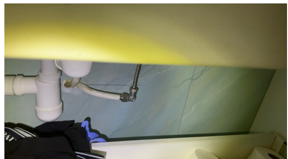
Utettheter i membran rundt rørgjennomføringer.
