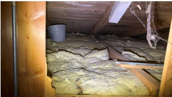
Det er registrert misfarging på undertak.
