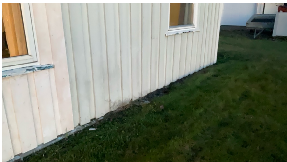
Lav høyde mellom grunnen og kledning. Lav høyde mellom grunnen og kledning. gir økt risiko for skader i treverket.
