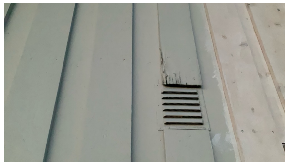
Råteskader på deler av kledning. Kledning som er råteskadet må skiftes ut.
