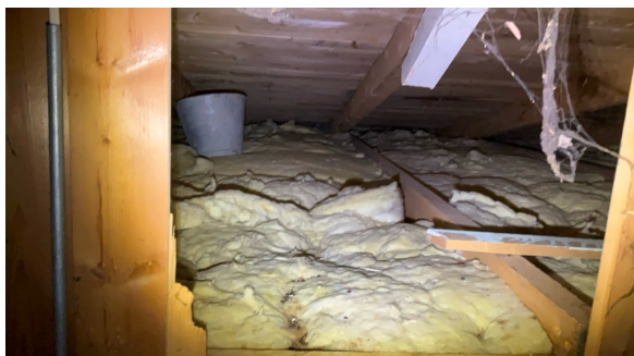
Det er registrert misfarging på undertak.
