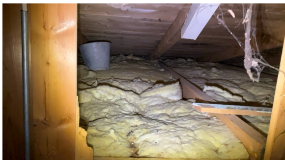
Det er registrert misfarging på undertak.
