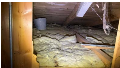
Det er registrert misfarging på undertak.
