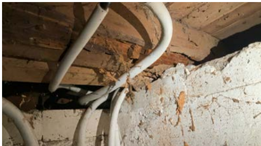
Råteskadet treverk er registrert i bjelkelaget.
