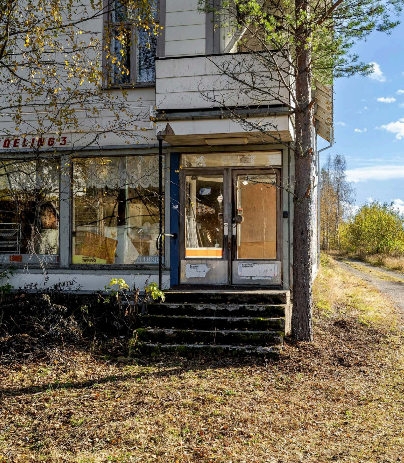
Bygningene er gamle med generelt preg av skader og eiendommen betraktes som et totalt rehabiliteringsobjekt.
