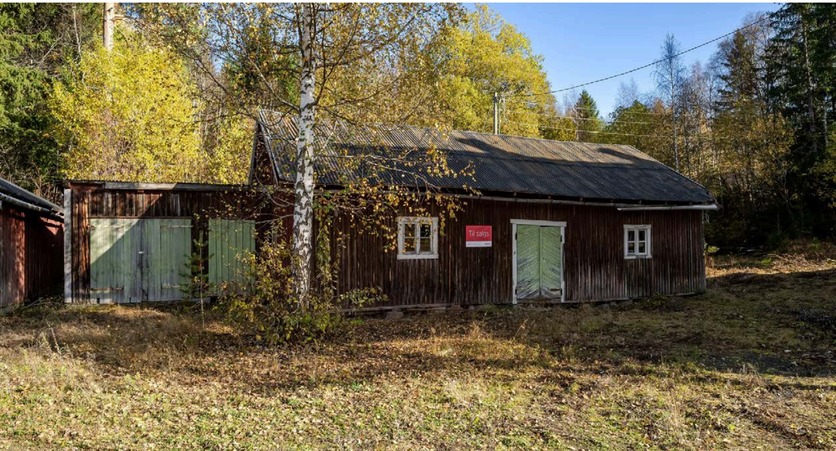
Uthus 2 har et bruksareal på ca. 92m 2 og består av 4 lagerrom. Bygget har gjennomgående lav standard. Generelt med preg av skader, aldersforvitring og manglende vedlikehold.
