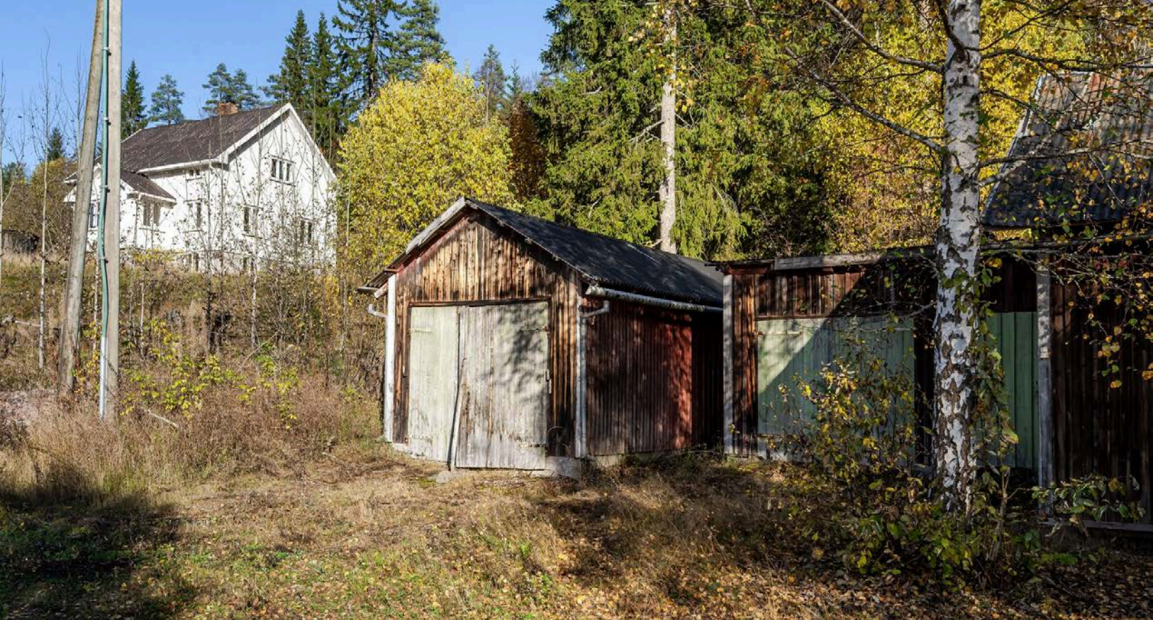
Eldre traktorgarasje på ca. 24m 2 . Bygget har gjennomgående lav standard. Generelt med preg av skader, aldersforvitring og manglende vedlikehold.
