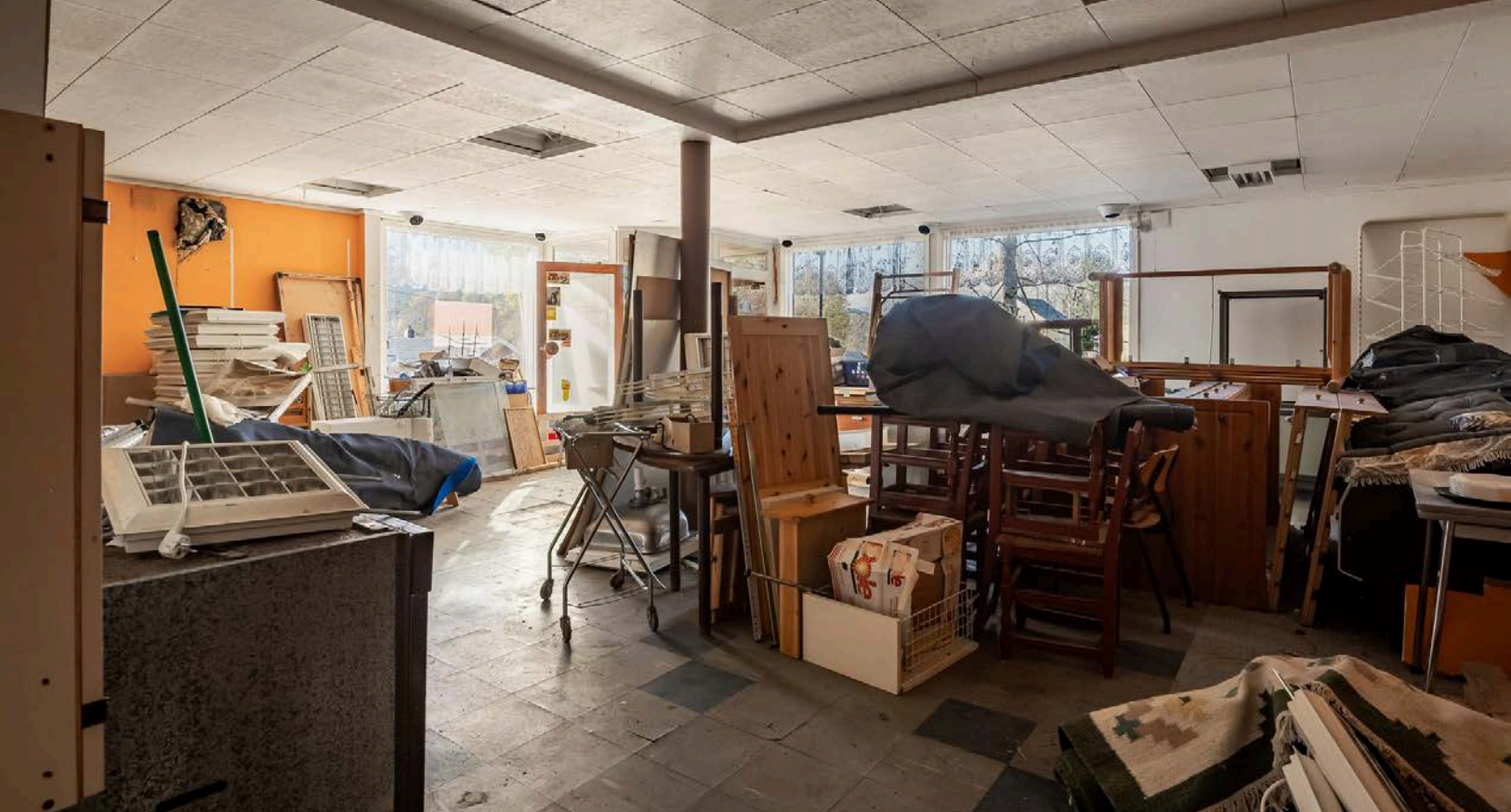
Bygget har gjennomgående lav standard og må betraktes som ett rehabiliteringsobjekt.
