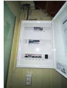
Sikringsskap i trappegang i 1. etasje
