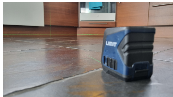
Måling av eventuelle planavvik med krysslaser. Her vist fra kjøkkenrommet inkl. spisestuen hvor største målte planavvik innenfor en diameter av 2 meter var ca. 4 mm, og største målte planavvik i hele rommet var ca. 9 mm. Også dette tilfredsstillende og mindre enn hva NS 3600 tillater av toleranseavvik.
