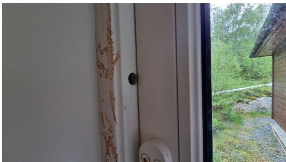
Manglende skruekapper på terrassedør i soverommet.
