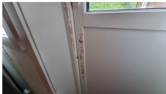
Ved befaring var det synlig byggeskum på terrassedøren i soverommet. Dette skal bli forsøkt fjernet opplyser eier.
