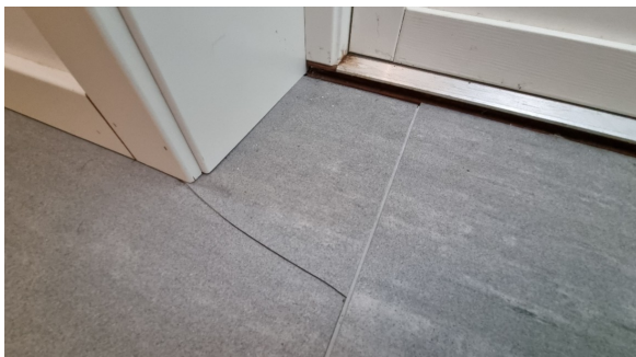
Skadet flis i det ene soverommet.
