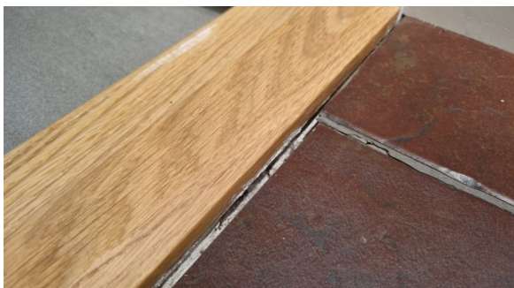
Manglende avslutning mot dørterskel, samt riss/utettheter i fuger i entre/gang.
