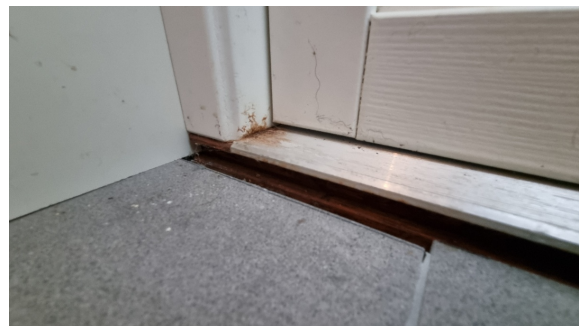
Manglende avslutning mot terskel på terrassedør i soverommet.
