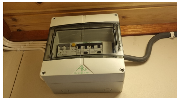
El-skap for tilbygget del. Det bemerkes at sikringer ikke er merket.
