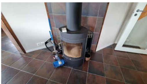
Peis-ovn fra byggeår.
