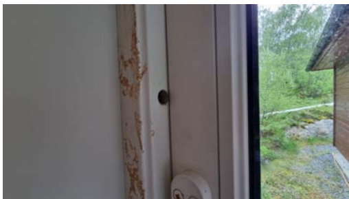
Manglende skrueskiver på terrassedør i soverommet.
