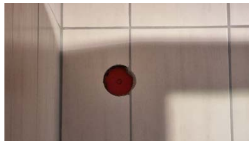
Hull i veggen bak dusjkabinettet.
