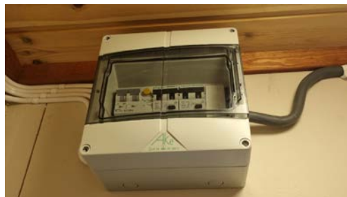
El-skap for tilbygget del. Det bemerkes at sikringer ikke er merket.
