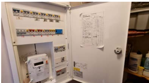
Kontroll av el-skapet
