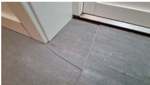
Skadet flis i det ene soverommet.
