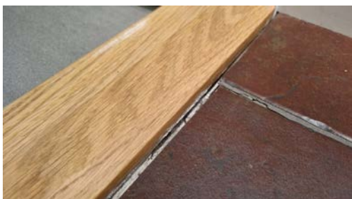
Manglende avslutning mot dørterskel, samt riss/utettheter i fuger i entre/gang.
