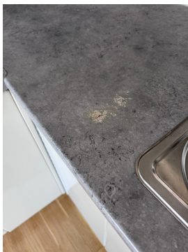
Slittasjemerke/skade på benkeplate.
