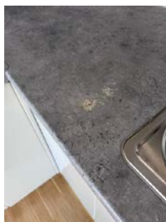
Slittasjemerke/skade på benkeplate.
