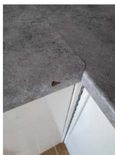
Slittasjemerke/skade på benkeplate.
