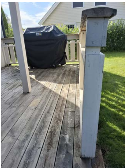
Terrassen med rekkverk er værslitt, og det registreres skjevheter i rekkverk.
