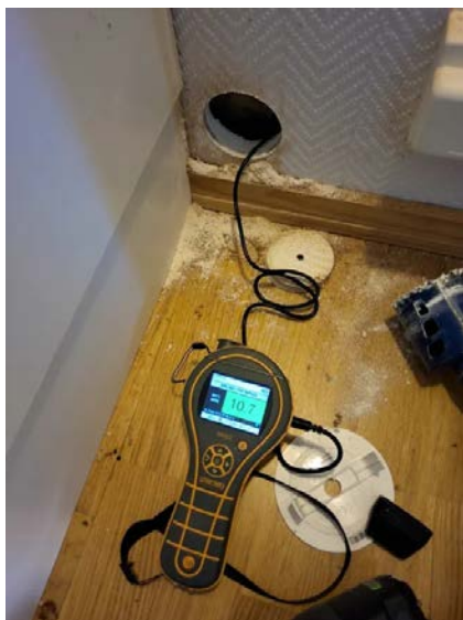
Bilde fra fuktmåling i veggkonstruksjon tilstøtende bad.
