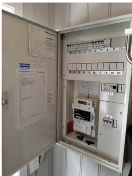
Sikringsskap er plassert i entré.
