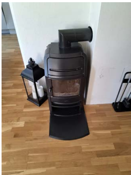
Vedovn med glassdør i stue.
