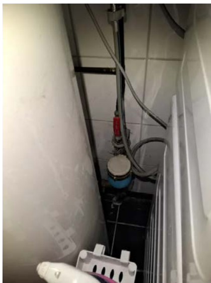
Hovedstoppekran er plassert på bad.
