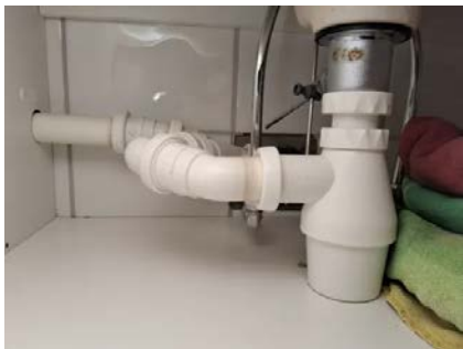
Det registreres motfall på avløpsrør under servant på bad.
