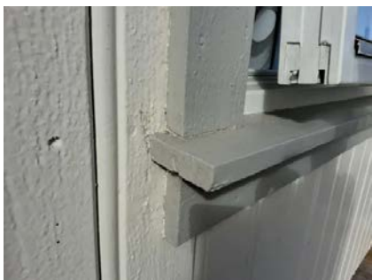
Lav klaring mellom utvendig listverk og vannbrett.
