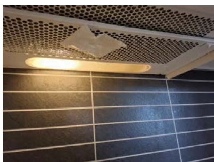
Avtrekkseffekt er testet med papir.
