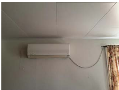
Varmepumpe er plassert i stue.
