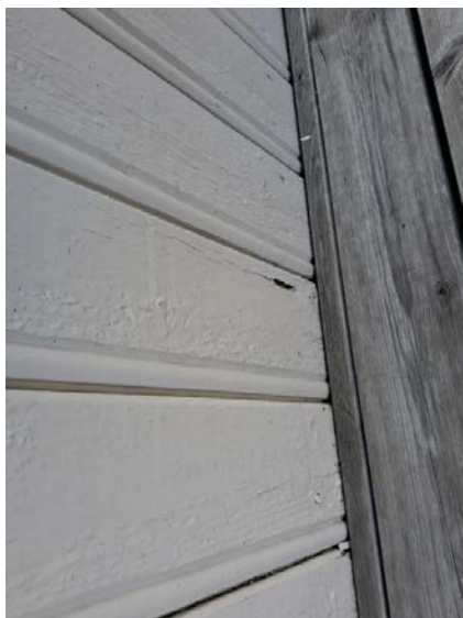
Det registreres krakelert og avflasket maling.
