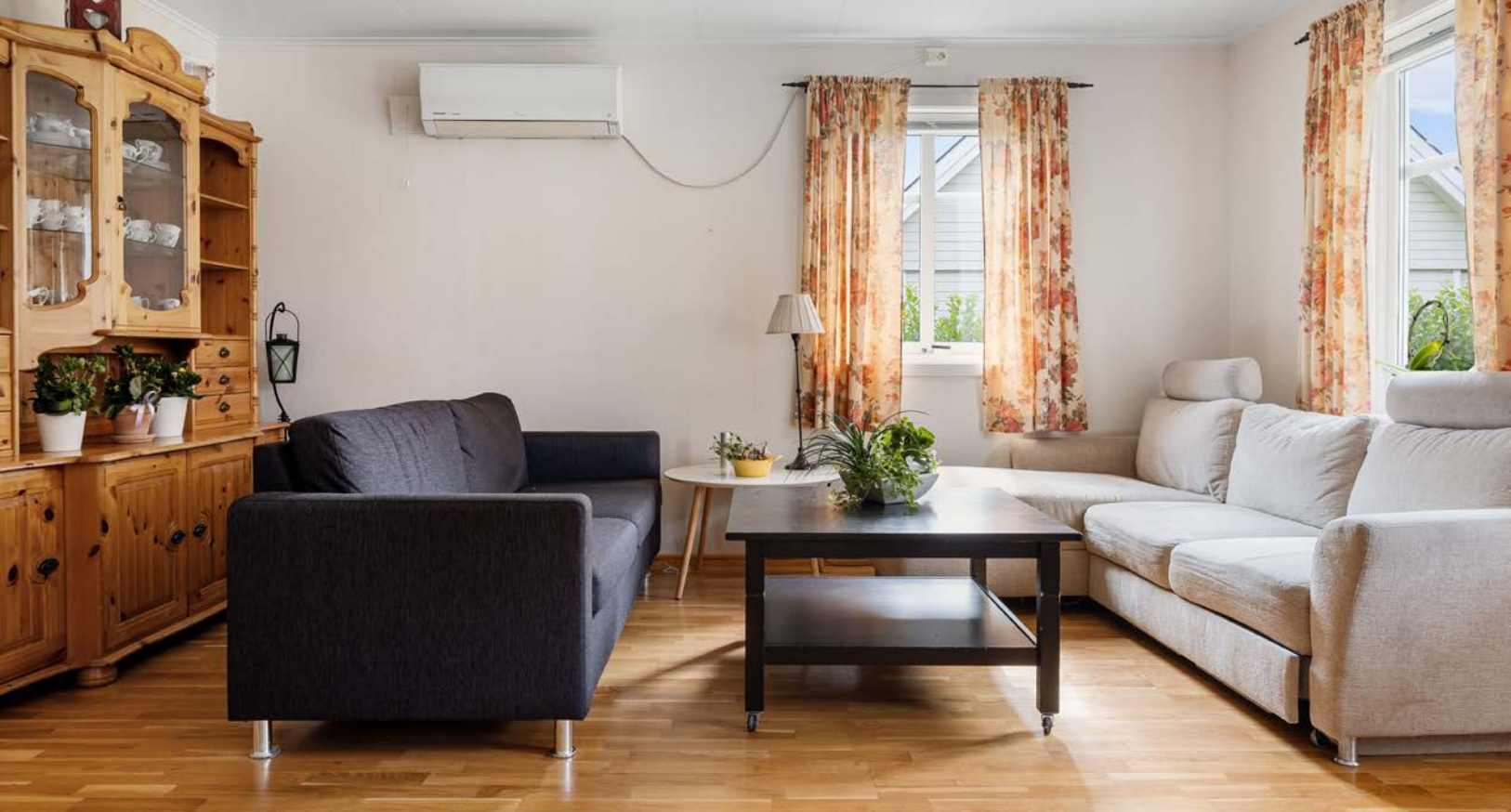
Det er montert varmepumpe i stua som gir jevn og god varme.
