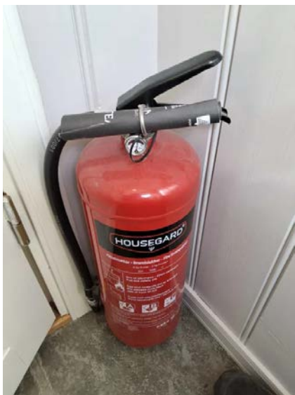
Brannslukningsapparat er plassert i entré.
