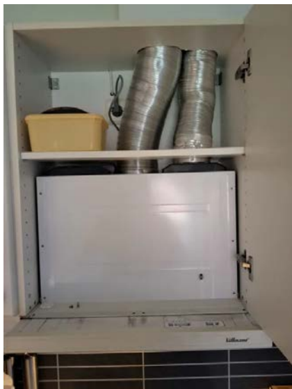
Mekanisk avtrekksvifte er plassert i overskap.
