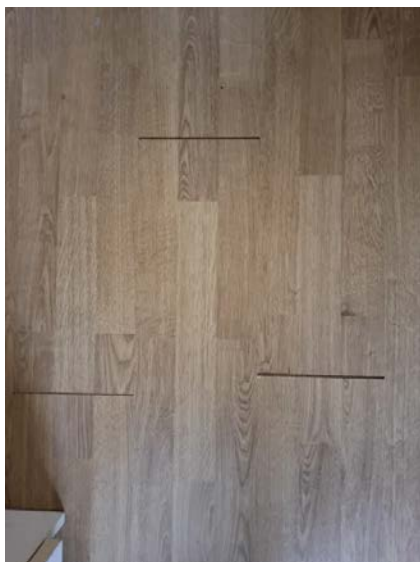
Det registreres gliper i endeskjøter på laminatgulv.
