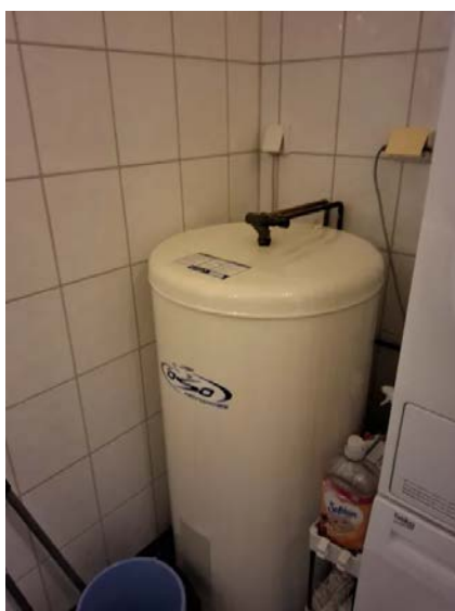
Varmtvannsbereder er plassert på bad.
