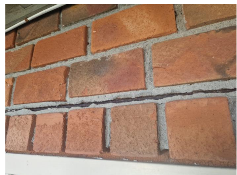
Frost og rustskader i tegl/armering teglvegg.
