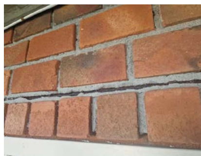
Frost og rustskader i tegl/armering teglvegg.
