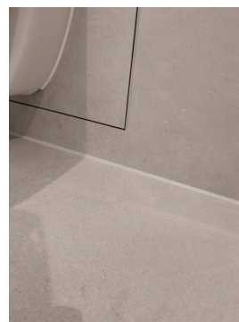
Etablert overløp til gulv med sluk via spalte under vegghengt toalett.
