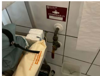
Hovedstoppekrane på baderom
