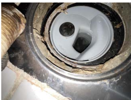
Slukk under dusjkabinett
