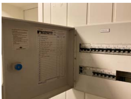
Sikringsskap i entreen
