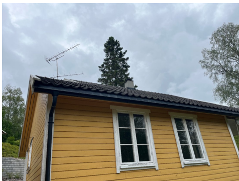
Det er svanke (nedbøyning) på takflate.
