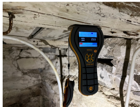
Påvist skadelig fukt i bjelker ved fuktmåling.
