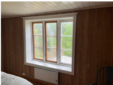
Soveromsvindu med punktert glass.
