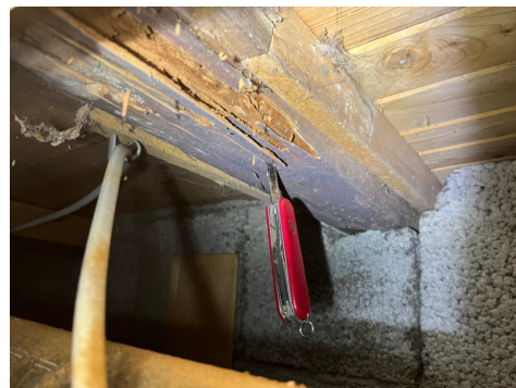
Råteskader i bjelkelag.
