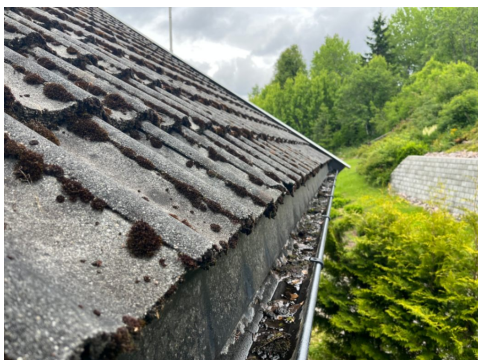
Takrenne har feil fall.
