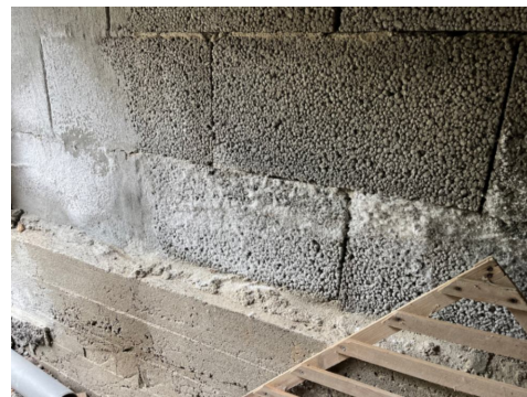
Saltutslag på vegg i krypkjeller er tegn til at fuktsikring/drenering har begrenset effekt.
