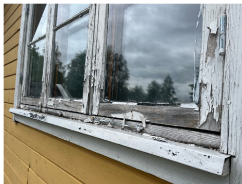
Utvendige vinduer har manglende vedlikehold.
