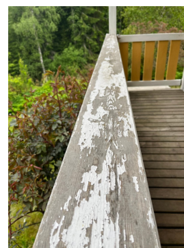
Toppbord på rekkverk må behandles.
