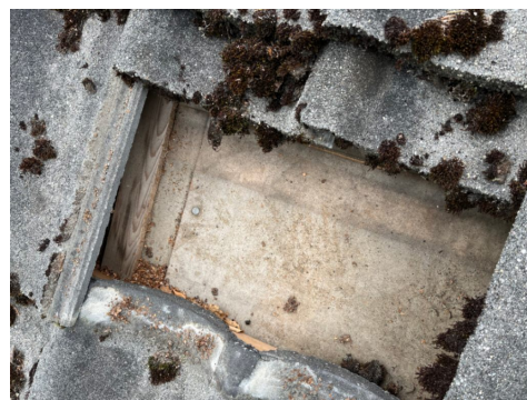
Undertaksplater har ikke klemt skjøt, med sløyfe over skjøten.
