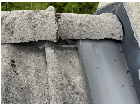
Takstein dekker ikke undertaket.
