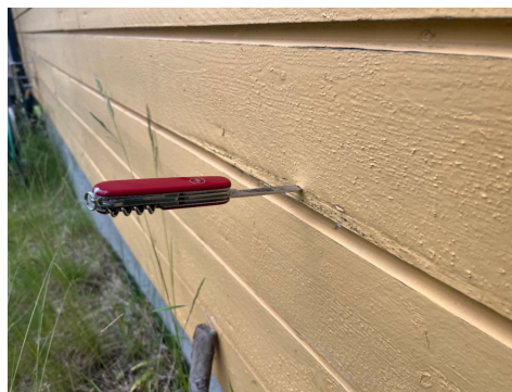
Råte i kledning.
