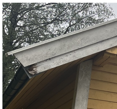
Vindski med råteskade, midlertidig beskyttet med stålplate av eier.
