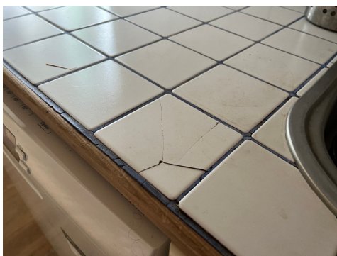
Sprekker i fliser.
