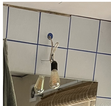
Løs ledning til lampe på bad.
