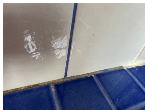
Manglende elastisk fugemasse i overgang vegg/gulv.
