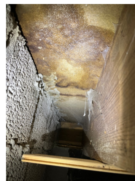
Synlige fuktmerker og sopp under gulvspan.
