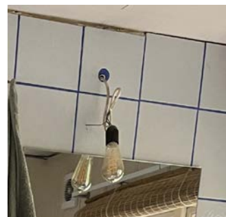
Løse ledning til lampe på bad.
