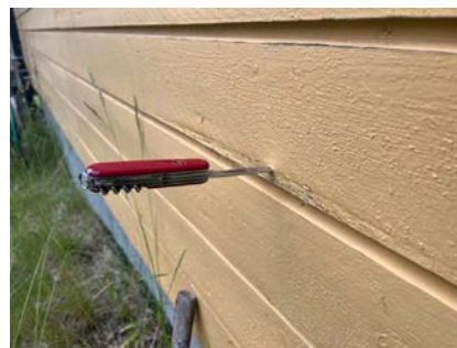
Råte i kledning.
