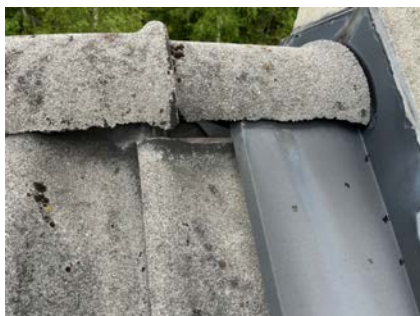
Takstein dekker ikke undertaket.
