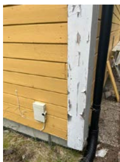
Hjørnekaske med avflasset maling.
