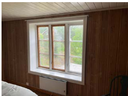
Soveromsvindu med punktert glass.
