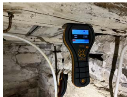
Påvist skadelig fukt i bjelker ved fuktmåling.
