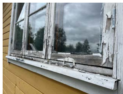
Utvendige vinduer har manglende vedlikehold.
