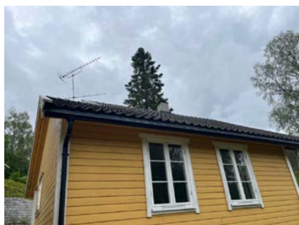
Det er svanke (nedbøyning) på takflate.
