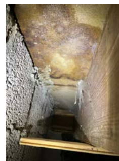
Synlige fuktmerker og sopp under gulvspan.
