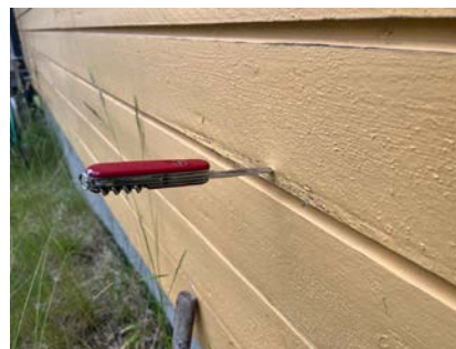
Råte i kledning.
