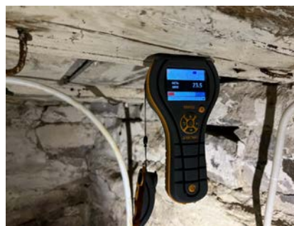
Påvist skadelig fukt i bjelker ved fuktmåling.
