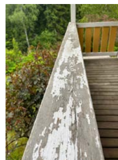
Toppbord på rekkverk må behandles.
