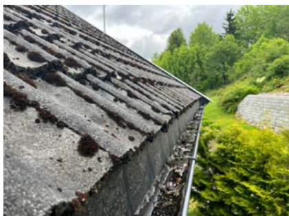
Takrenne har feil fall.
