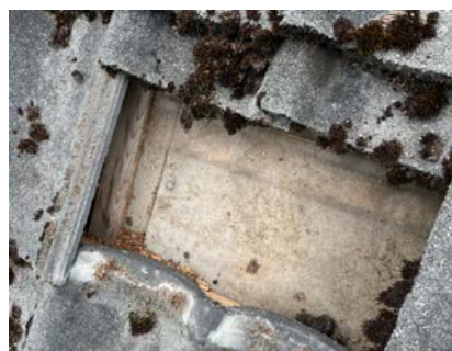
Undertaksplater har ikke klemt skjøt, med sløyfe over skjøten.
