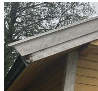
Vindski med råteskade, midlertidig beskyttet med stålplate av eier.
