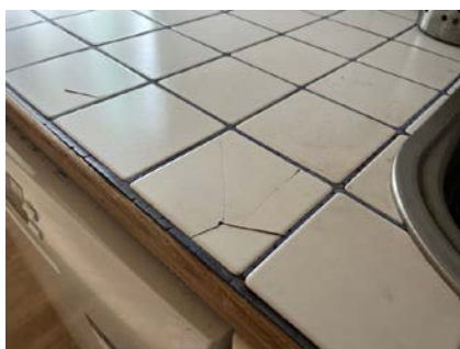
Sprekker i fliser.
