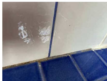
Manglende elastisk fugemasse i overgang vegg/gulv.
