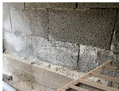
Saltutslag på vegg i krypkjeller er tegn til at fuktsikring/drenering har begrenset effekt.
