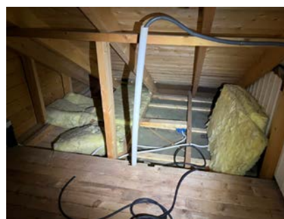
Isolasjon må legges på plass.
