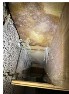
Synlige fuktmerker og sopp under gulvspan.
