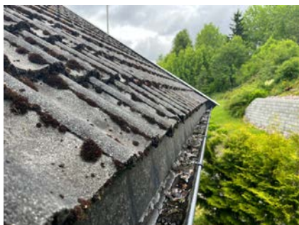
Takrenne har feil fall.
