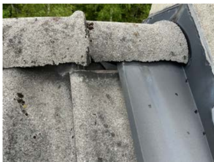
Takstein dekker ikke undertaket.
