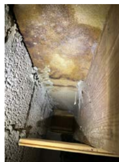
Synlige fuktmerker og sopp under gulvspan.
