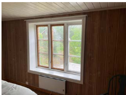
Soveromsvindu med punktert glass.
