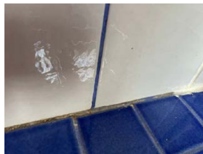
Manglende elastisk fugemasse i overgang vegg/gulv.
