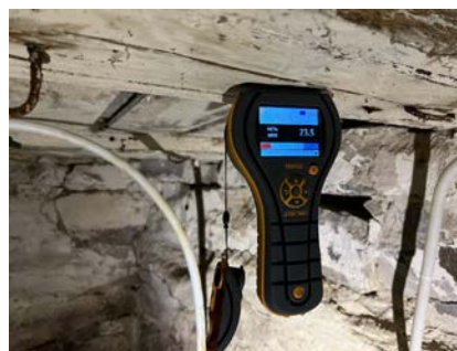
Påvist skadelig fukt i bjelker ved fuktmåling.
