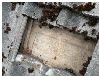
Undertaksplater har ikke klemte skjøt, med sløyfe over skjøten.
