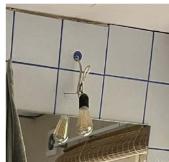
Løs ledning til lampe på bad.
