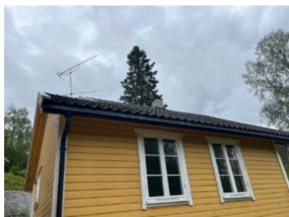
Det er svanke (nedbøyning) på takflate.
