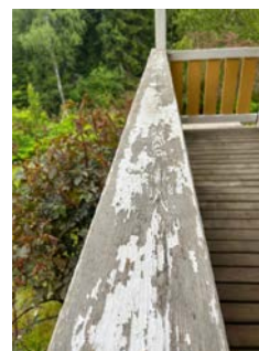
Toppbord på rekkverk må behandles.
