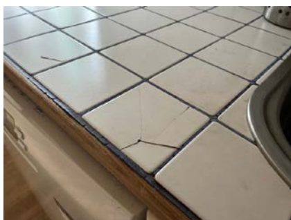
Sprekker i fliser.
