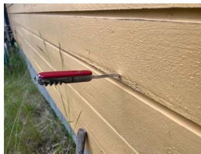
Råte i kledning.
