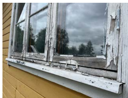
Utvendige vinduer har manglende vedlikehold.
