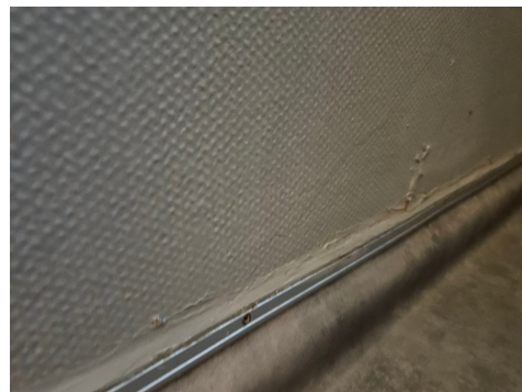
Det er ikke forelagt dokumentasjon på godkjent våtroms system på vegg. Overgang vegg-gulv har en ikke godkjent våtromsløsning.
