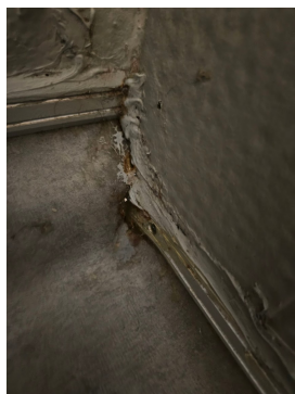
Stor fare for lekkasje i overgang vegg / gulvbelegg. Dette er ikke en dokumentert godkjent løsning
