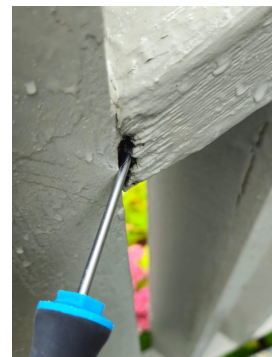
Stedvis råteskader på rekkverk.
