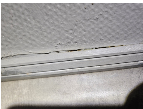
Overgang mellom vegg og gulvbelegg er ikke tett.
