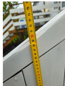
Rekkverk er for lavt etter dagens krav.
