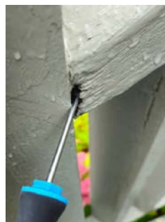
Stedvis råteskader på rekkverk.
