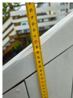
Rekkverk er for lavt etter dagens krav.
