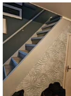
Det er ikke montert rekkverk og trappen er relativt bratt
