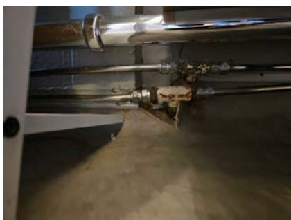
Det er påvist feil ved gjennomføring i gulv. Fare for lekkasje til underliggende konstruksjoner.
