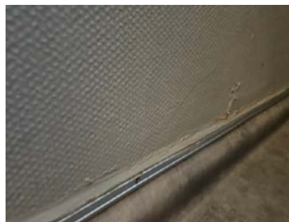
Det er ikke forelagt dokumentasjon på godkjent våtroms system på vegg. Overgang vegg-gulv har en ikke godkjent våtromsløsning.
