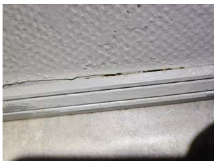
Overgang mellom vegg og gulvbelegg er ikke tett.
