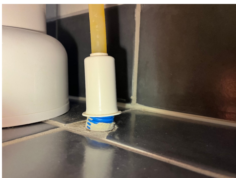
Gjennomføring i gulv uten synlig mansjett.
