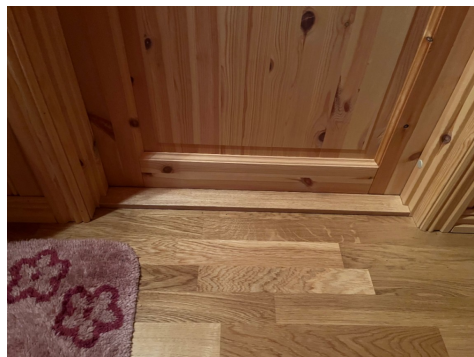
Manglende luftespalte under dør.
