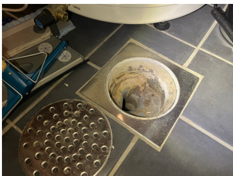
Sluk i vaskeromsdelen.
