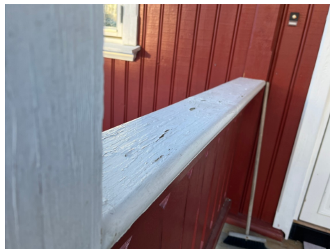
Toppbord på rekkverk må vedlikeholdes.
