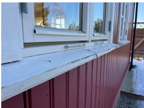
Vannbrett må vedlikeholdes.
