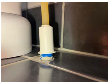
Gjennomføring i gulv uten synlig mansjett.
