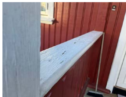
Toppbord på rekkverk må vedlikeholdes.
