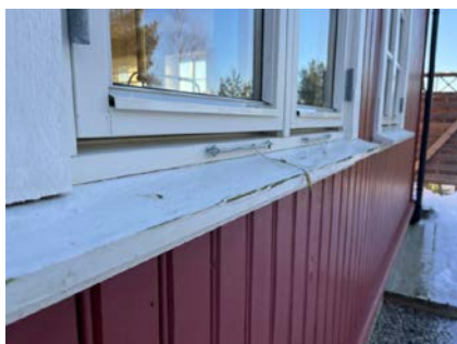
Vannbrett må vedlikeholdes.
