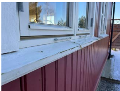
Vannbrett må vedlikeholdes.
