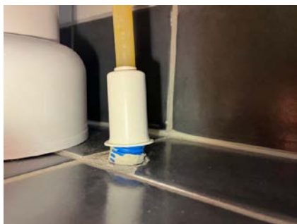
Gjennomføring i gulv uten synlig mansjett.
