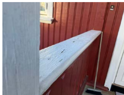
Toppbord på rekkverk må vedlikeholdes.
