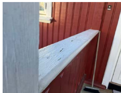
Toppbord på rekkverk må vedlikeholdes.
