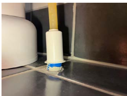
Gjennomføring i gulv uten synlig mansjett.
