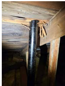
Uisolert soilrør for lufting av kloakk.
