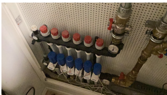
Fordelerskap på bodrom.
