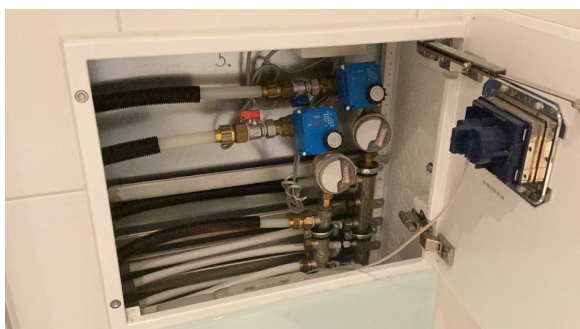
Fordelerskap for vannrør over toalett.
