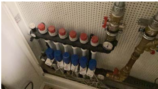
Fordelerskap på bodrom.
