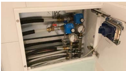
Fordelerskap for vannrør over toalett.
