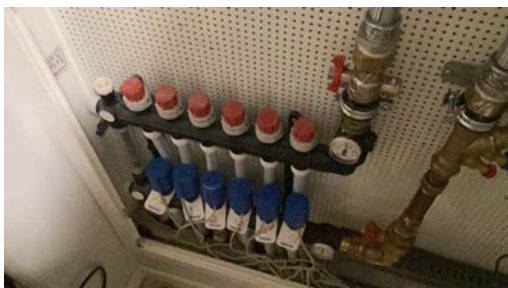
Fordelerskap på bodrom.
