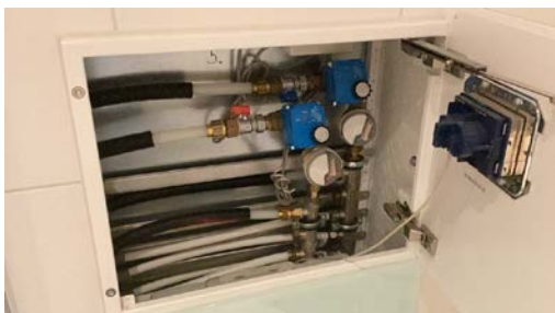
Fordelerskap for vannrør over toalett.
