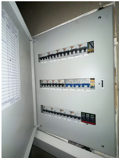
Viser sikringskapp på teknisk rom i kjeller.
