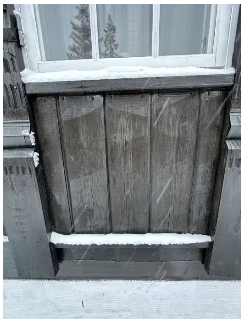
Det registreres stedvis værslitt/oppsprukket trekledning.
