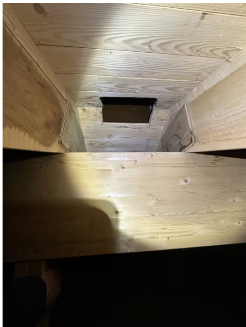
Det må utføres tiltak ved luftehatt slik at snø ikke havner på kaldloft.
