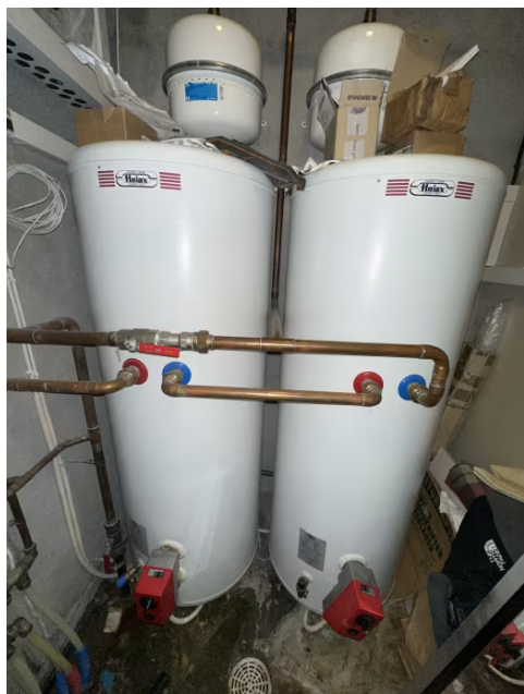
Viser varmtvannsberedere plassert på teknisk rom i kjeller.
