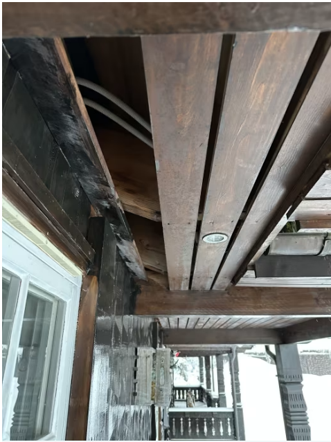
Kledningsbord mangler ved gesimskasse.
