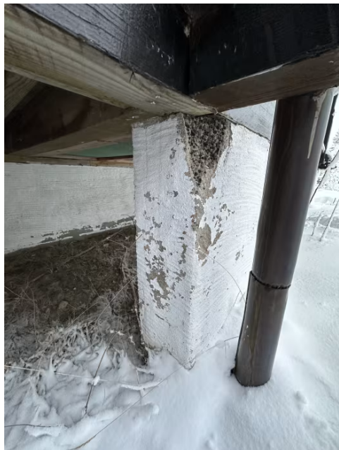
Pilarer har stedvis avskalling/ skader.
