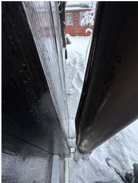
Det ble registrert buling/skade i nedløpsrør som er et symptom på frostspreng.
