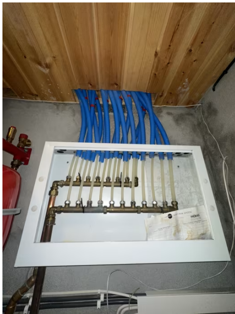
Viser innvendig innstallasjoner i fordelerskap.
