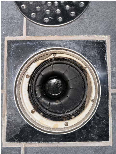
Viser sluk i dusjsonen.
