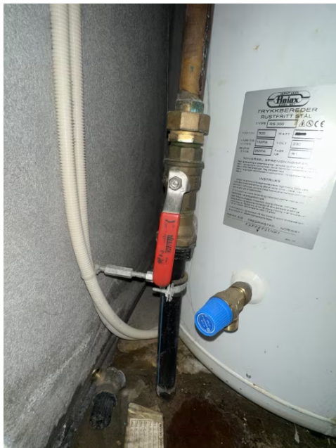
Viser plassering av hovestoppekran på teknisk rom.
