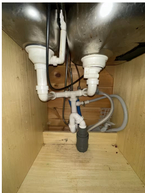
Viser vann- og avløpsinnstallasjoner under kum.
