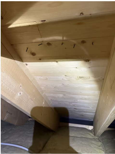
Det registreres spiker igjennom undertak.
