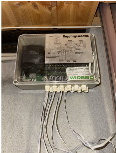
Viser styresentral plassert på teknisk rom.
