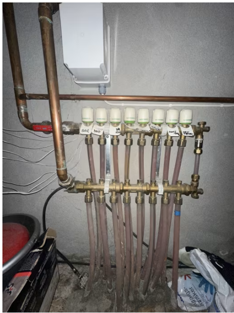
Viser vegghengte fordelere til gulvvarme i kjeller.
