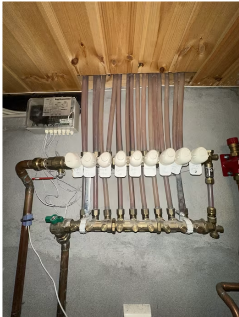
Viser vegghengte fordelere til gulvvarme i 1.etasje
