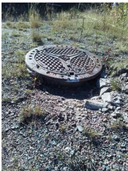
ødelagt kum utvendig
