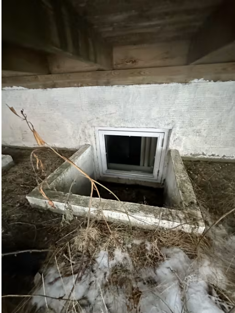
Det registreres ikke utvendig fuktsikring ved synlige grunnmurer.
