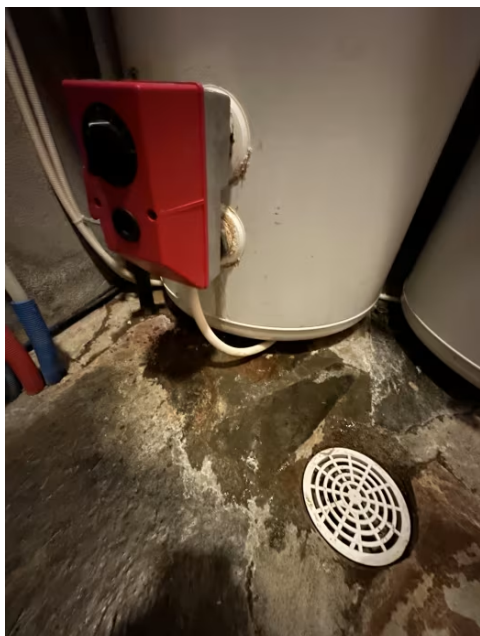
Det registreres drypplekkasje på bereder.
