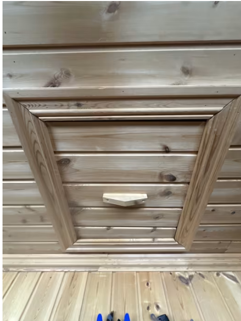
Det er etablert en luke i taket i boden for adkomst til loft
