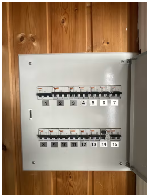
Viser sikringskap i 1.etasje
