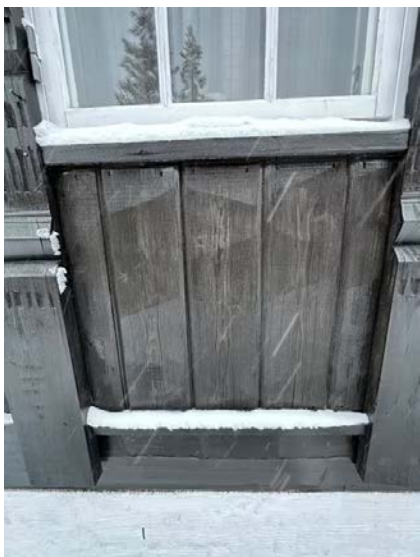
Det registreres stedvis værslitt/oppsprukket trekledning.
