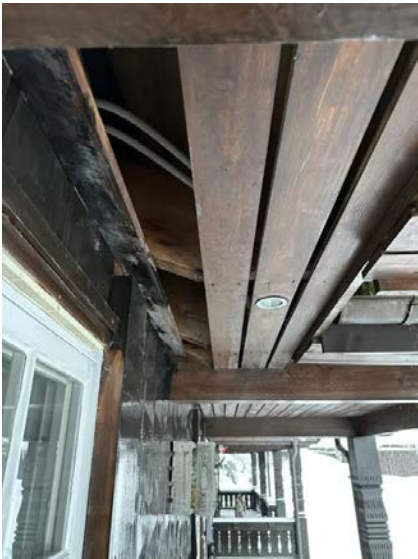
Kledningsbord mangler ved gesimskasse.
