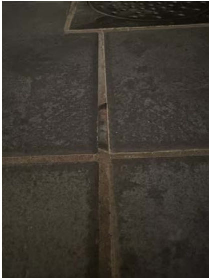
Det registreres riss / sprekker i flisfuger på gulv.
