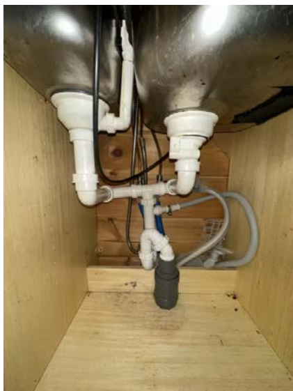
Viser vann- og avløpsinnstallasjoner under kum.
