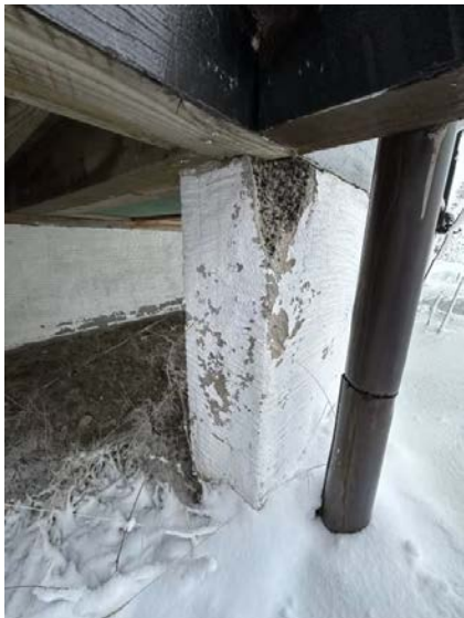
Pilarer har stedvis avskalling/ skader.
