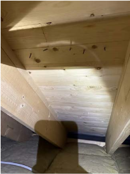
Det registreres spiker igjennom undertak.
