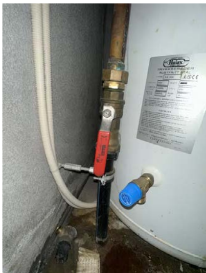
Viser plassering av hovestoppekran på teknisk rom.
