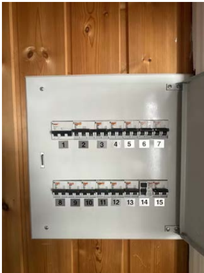
Viser sikringsskap i 1.etasje
