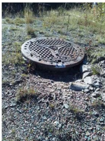
Ødelagt kum utvendig
