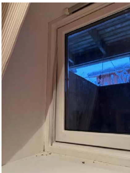
Tettelist på rømningsvindu på soverom er løs.
