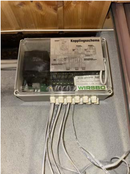
Viser styresentral plassert på teknisk rom.
