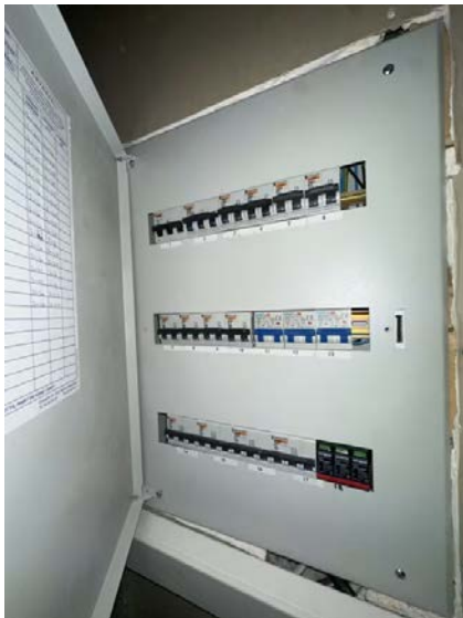
Viser sikringskap på teknisk rom i kjeller.
