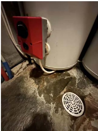
Det registreres drypplekkasje på bereder.
