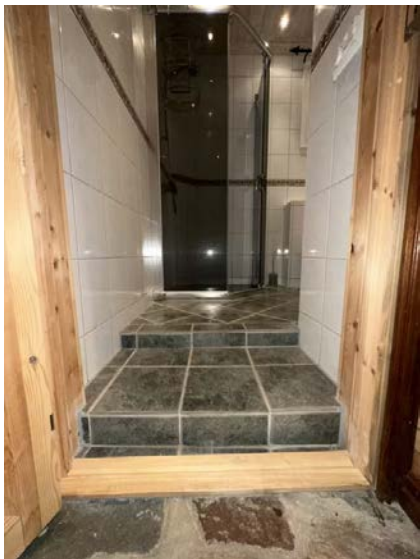
Trinn opp til bad. Manglende tettesjikt ved døråpning.
