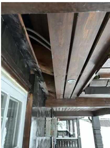
Kledningsbord mangler ved gesimskasse.
