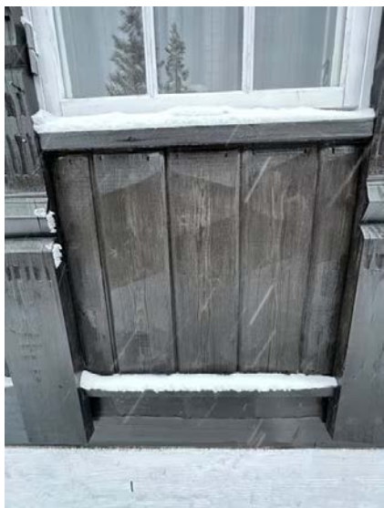
Det registreres stedvis værslitt/oppsprukket trekledning.
