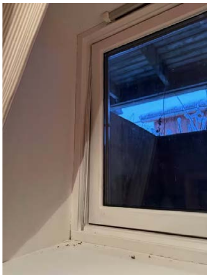
Tettelist på rømningsvindu på soverom er løs.
