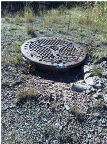
ødelagt kum utvendig
