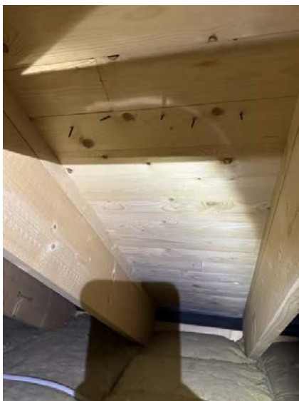
Det registreres spiker igjennom undertak.
