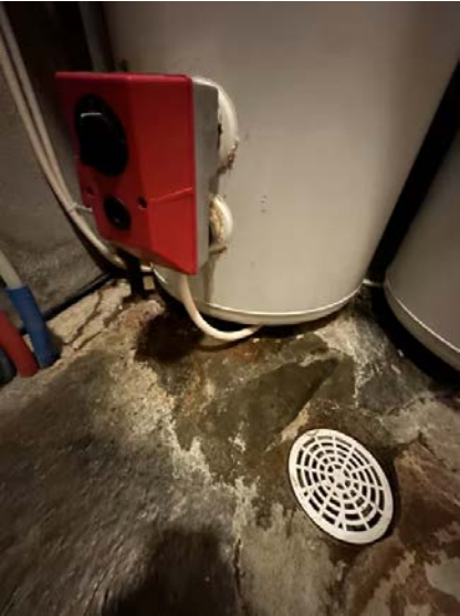
Det registreres drypplekkasje på bereder.
