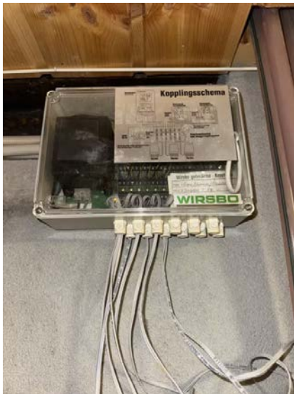
Viser styresentral plassert på teknisk rom.
