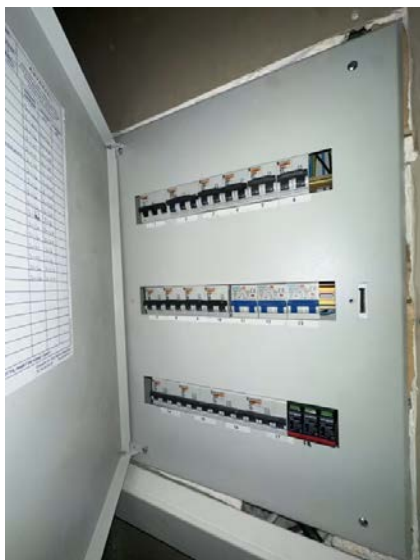
Viser sikringsskap på teknisk rom i kjeller.
