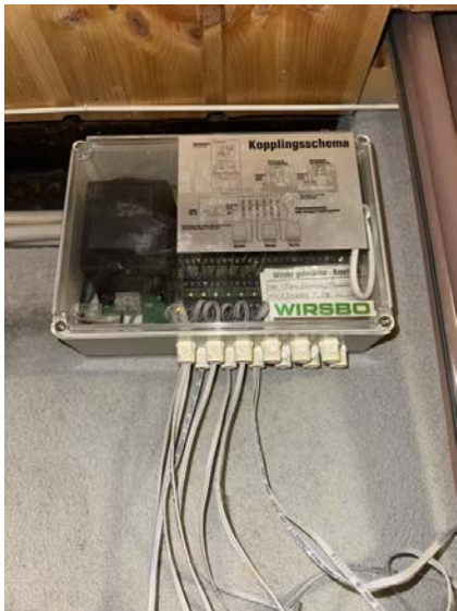
Viser styresentral plassert på teknisk rom.
