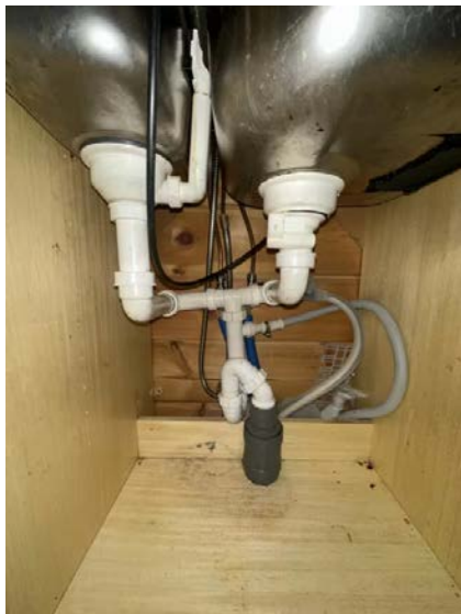
Viser vann- og avløpsinnstallasjoner under kum.
