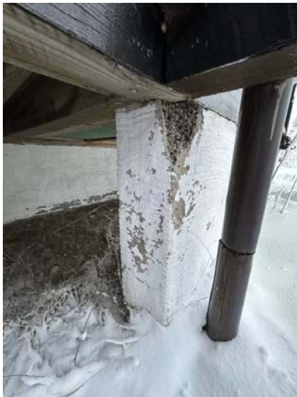
Pilarer har stedvis avskalling/ skader.
