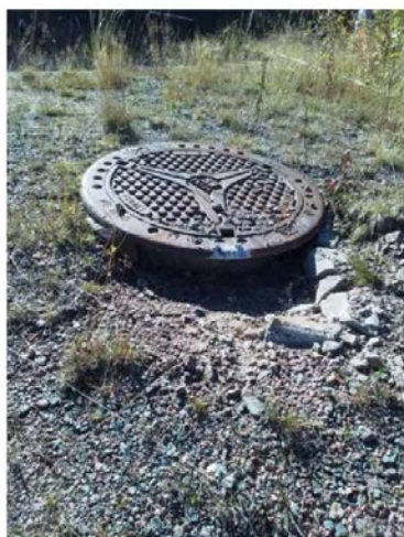
ødelagt kum utvendig
