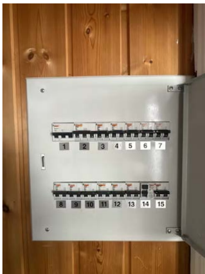
Viser sikringsskap i 1.etasje
