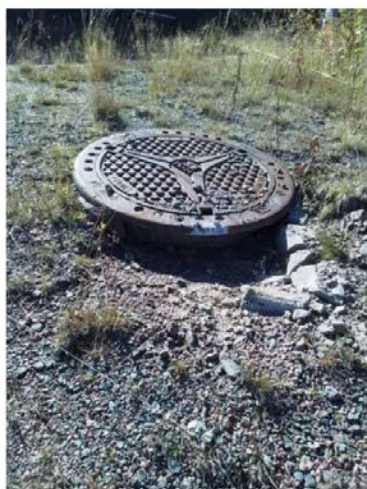
ødelagt kum utvendig
