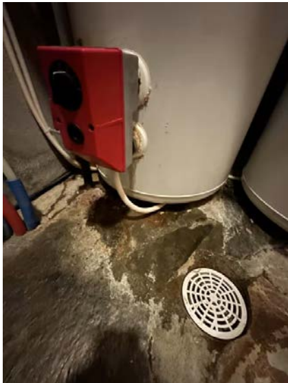
Det registreres drypplekkasje på bereder.
