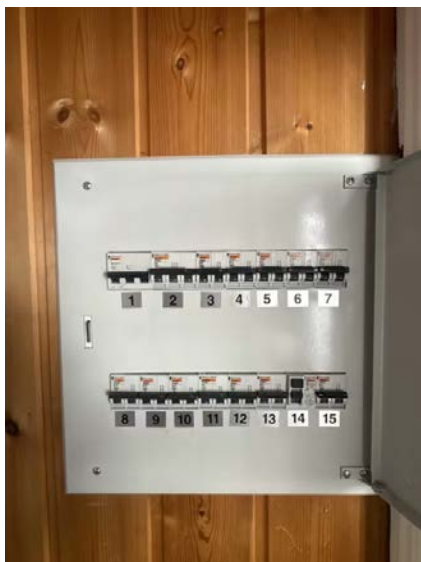
Viser sikringsskap i 1.etasje
