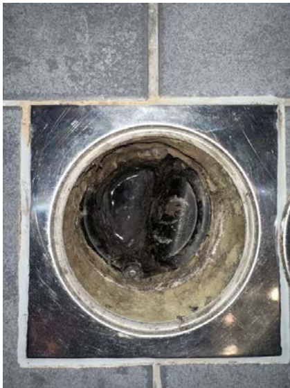
Viser sluk ved boblebad
