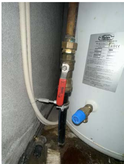
Viser plassering av hovedstoppekran på teknisk rom.
