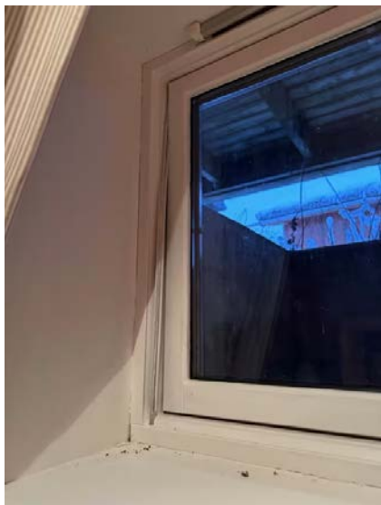
Tettelist på rømningsvindu på soverom er løs.
