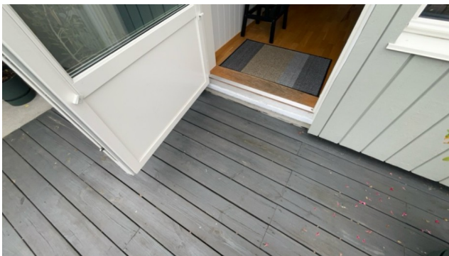
Skadet list under terrassedør.
