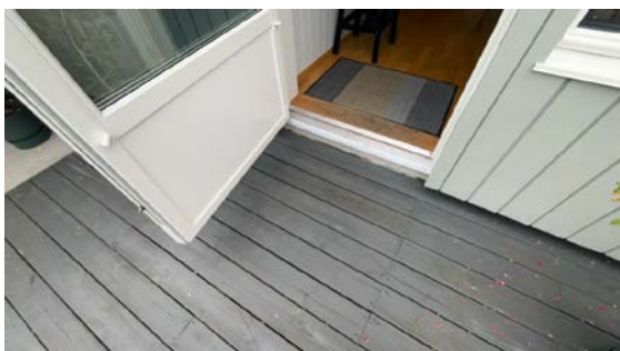
Skadet list under terrassedør.
