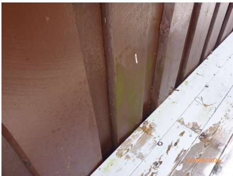
Vannsprut på vegg
