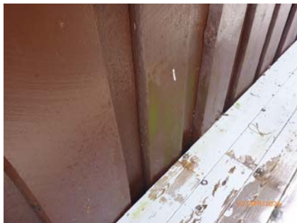
Vannsprut på vegg
