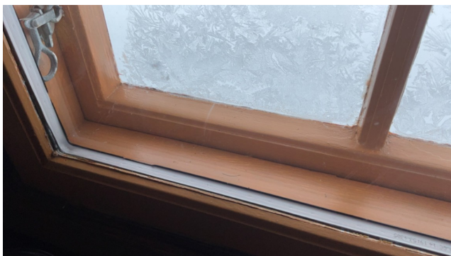
Må hensyntas alder på koblete vindu, montert innerglass i isolerglass innvendig
