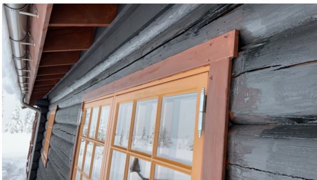
Manglende vannbrett/beslag på vindu over de eldste vinduene
