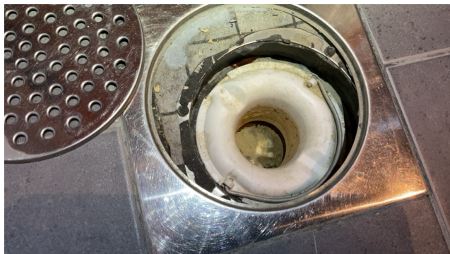
Synlig tettesjikt under klemring
