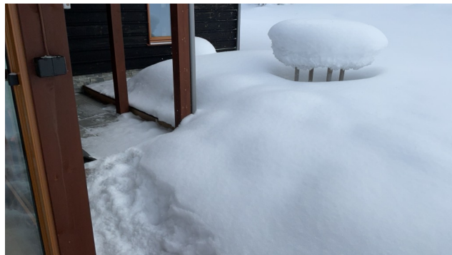
Terrasse er snødekket på befaring, tilstandsvurderingen og areal er derfor ikke mulig
