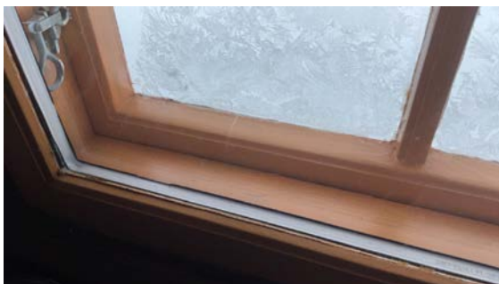
Må hensyntas alder på koblede vindu, montert innerglass i isolerglass innvendig
