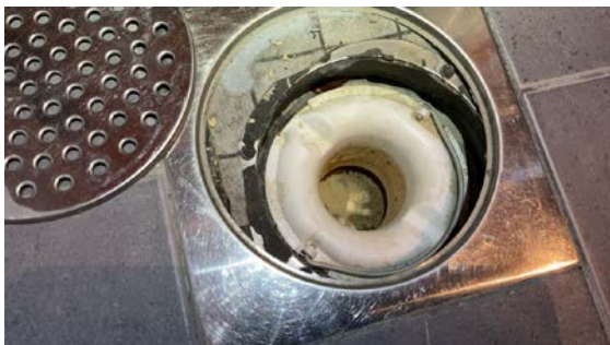
Synlig tettesjikt under klemring
