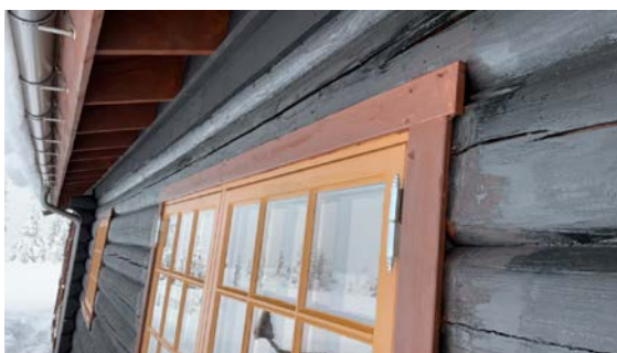
Manglende vannbrett/bslag på vindu over de eldste vinduene
