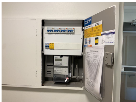
Sikringsskap plassert i felles oppgang.
