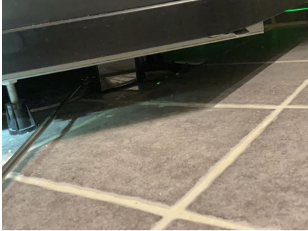
Kontroll av sluk utført med speil grunnet plassering av dusjkabinett.
