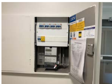
Sikringsskap plassert i felles oppgang.
