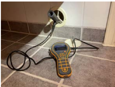
Fuktmåling i ventil viser tørre verdier.
