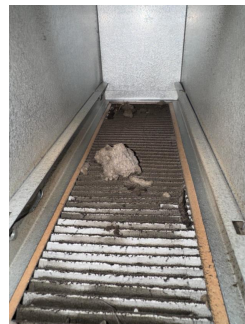
Manglende vedlikehold/service. Bildet viser filter i ventilasjonsaggregat.
