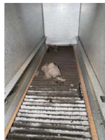
Manglende vedlikehold/service. Bildet viser filter i ventilasjonsaggregat.
