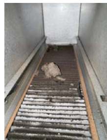
Manglende vedlikehold/service. Bildet viser filter i ventilasjonsaggregat.
