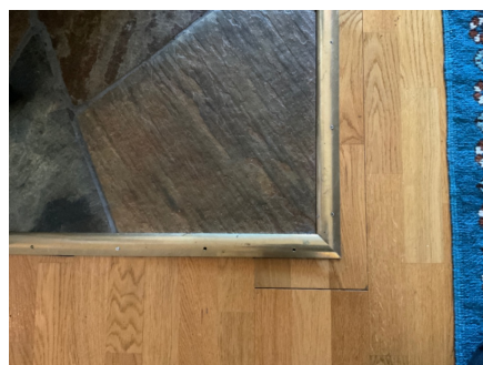
Løs messinglist på gulv.
