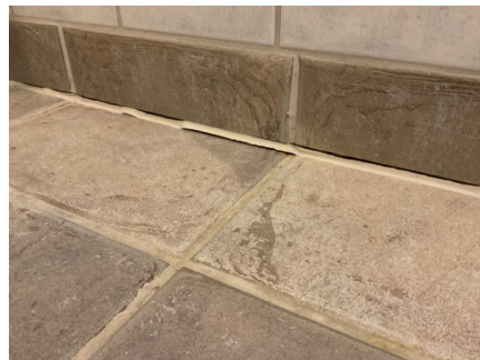
Sprekk i overgang gulv vegg.
