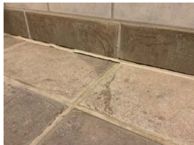
Sprekk i overgang gulv vegg.
