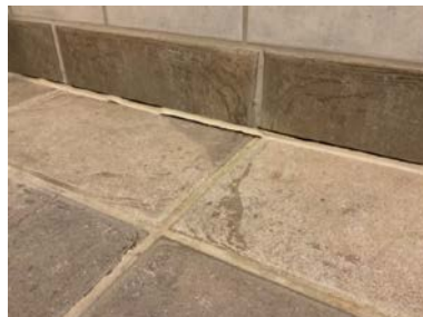
Sprekk i overgang gulv vegg.
