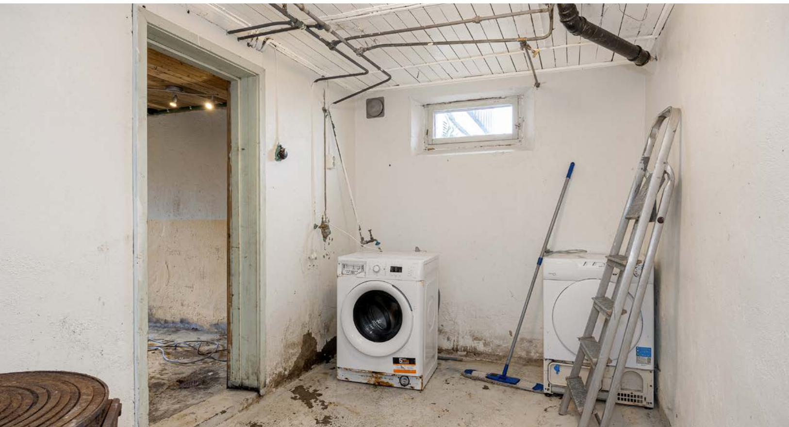
Vaskerom i kjeller med opplegg for vaskemaskin.
